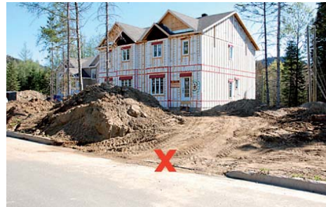
Accès au chantier sans stabilisation
