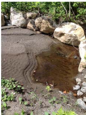
Trappe à sédiments pleine
