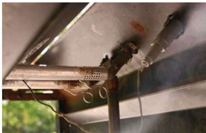
Figure 1: conduits pour l'entrée de gaz.
