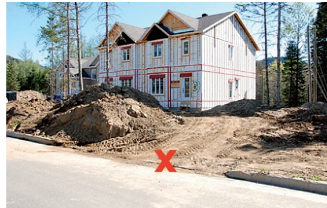
Accès au chantier sans stabilisation
