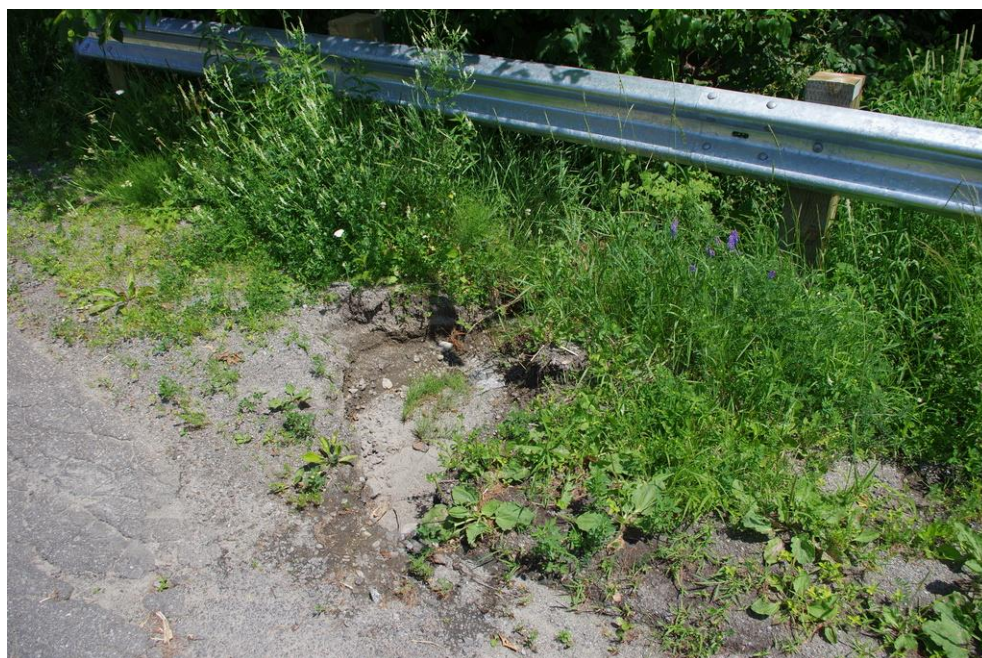
Photo 4 Des ravins d'érosion sont présents sur la crête de la digue.
