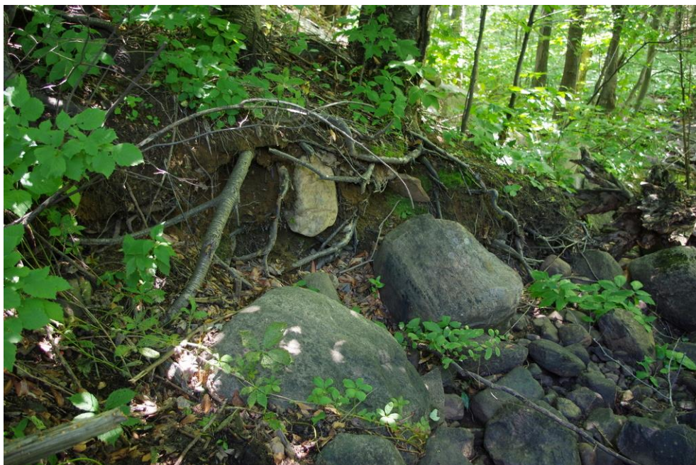
Photo 9 Les parties non protégées du canal sont assujetties à l'érosion.
